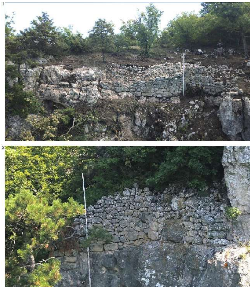
Рис. 4. Мангупская крепость. Укрепления А.ХІІ и А.ХІІІ. 1 – Фас лицевого панциря укрепления А.ХІІ, фрагмент. 2 – Фас лицевого панциря укрепления А.ХІІІ.
