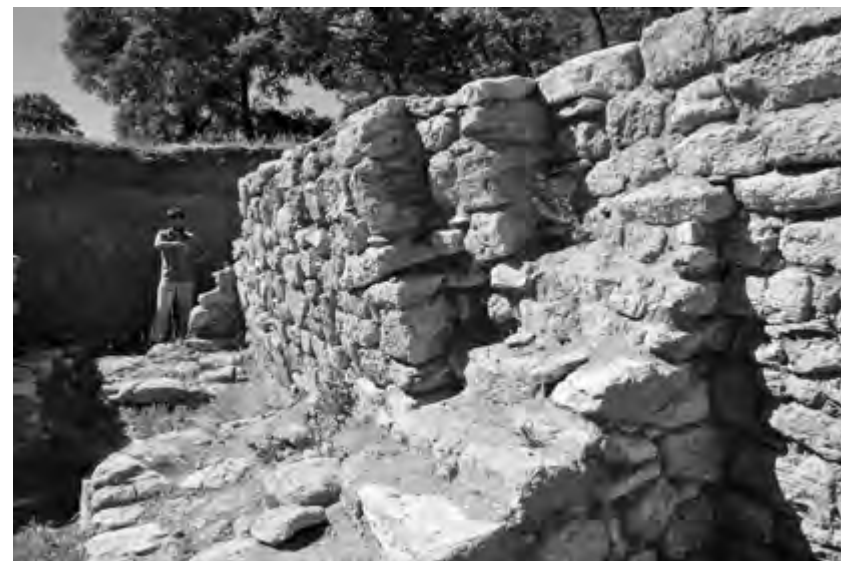
Рис. 1. Значительный наклон субширотной городской стены на юг. Раскоп XXVIII. Фото 2018 г. Вид с востока
